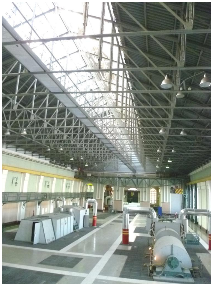
Современный вид машзала на ГЭС им. Смидовича
